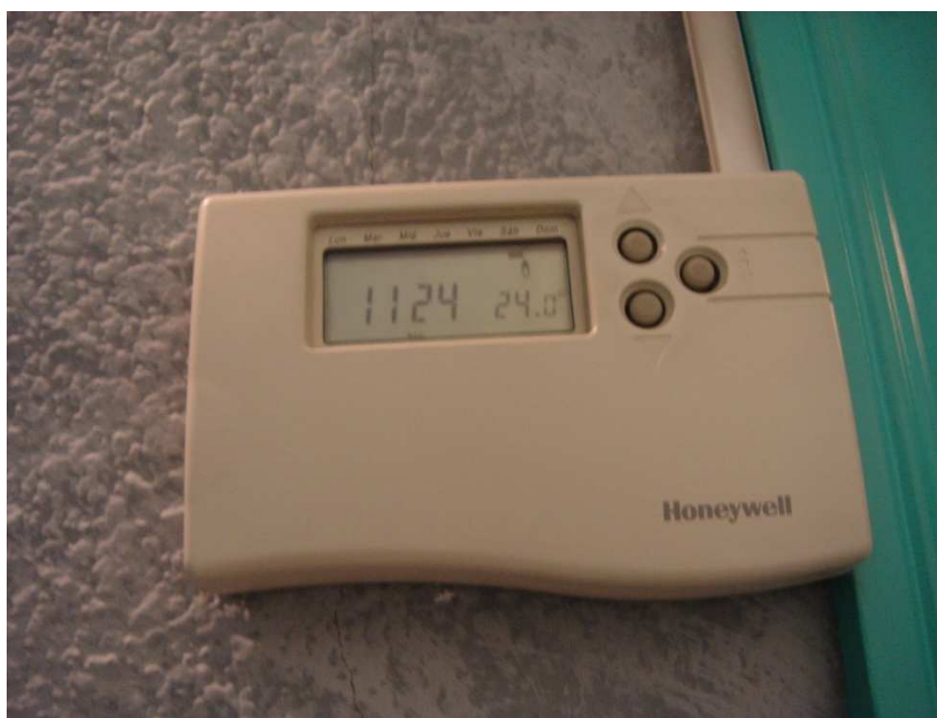
Figura 1 Quadre de comandaments pel control de la temperatura de la sala.
